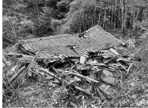
写真⑧ 崩壊する空き家
